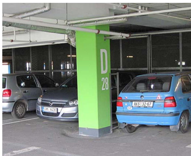
Obr. 4. Sedání sloupů skeletu v důsledku nekvalitního inženýrskogeologického průzkumu
